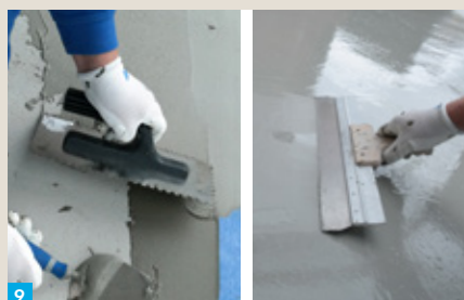
9 Lekko zwilż całą powierzchnię balkonu lub tarasu i nanieś pierwszą warstwę zaprawy uszczelniającej HYDRO FLEX 1C.
